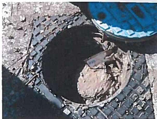
Figure n°3 : Vue du piézomètre PZB
